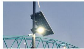
小型風力発電&ソーラーパネルによる完全自立型の街路灯システム マブチハイブリットボールII (製品内)
