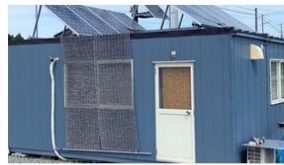
ソーラーパネルとの連携による仮設事務所での節電対策 建設現場の仮設事務所
